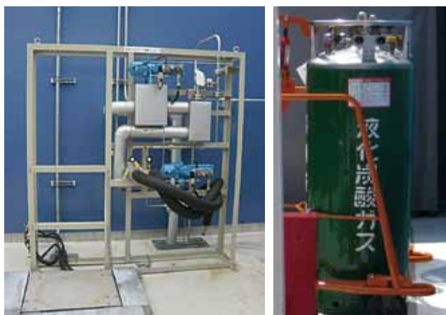
写真③ 液化CO 2 を充填するための設備(左)と出荷用ボンベ(右)。
