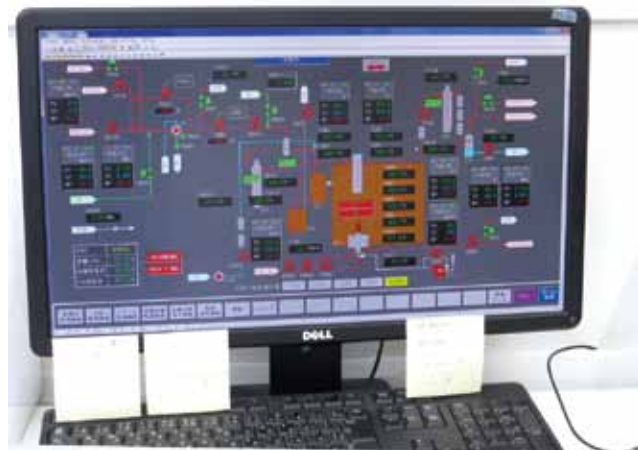
写真④ 水素製造のすべての工程を管理するモニター。日本では専門有資格者(高圧ガス取り扱い資格者)が必要(今号の『海外交通事情報告』ご参照)。
